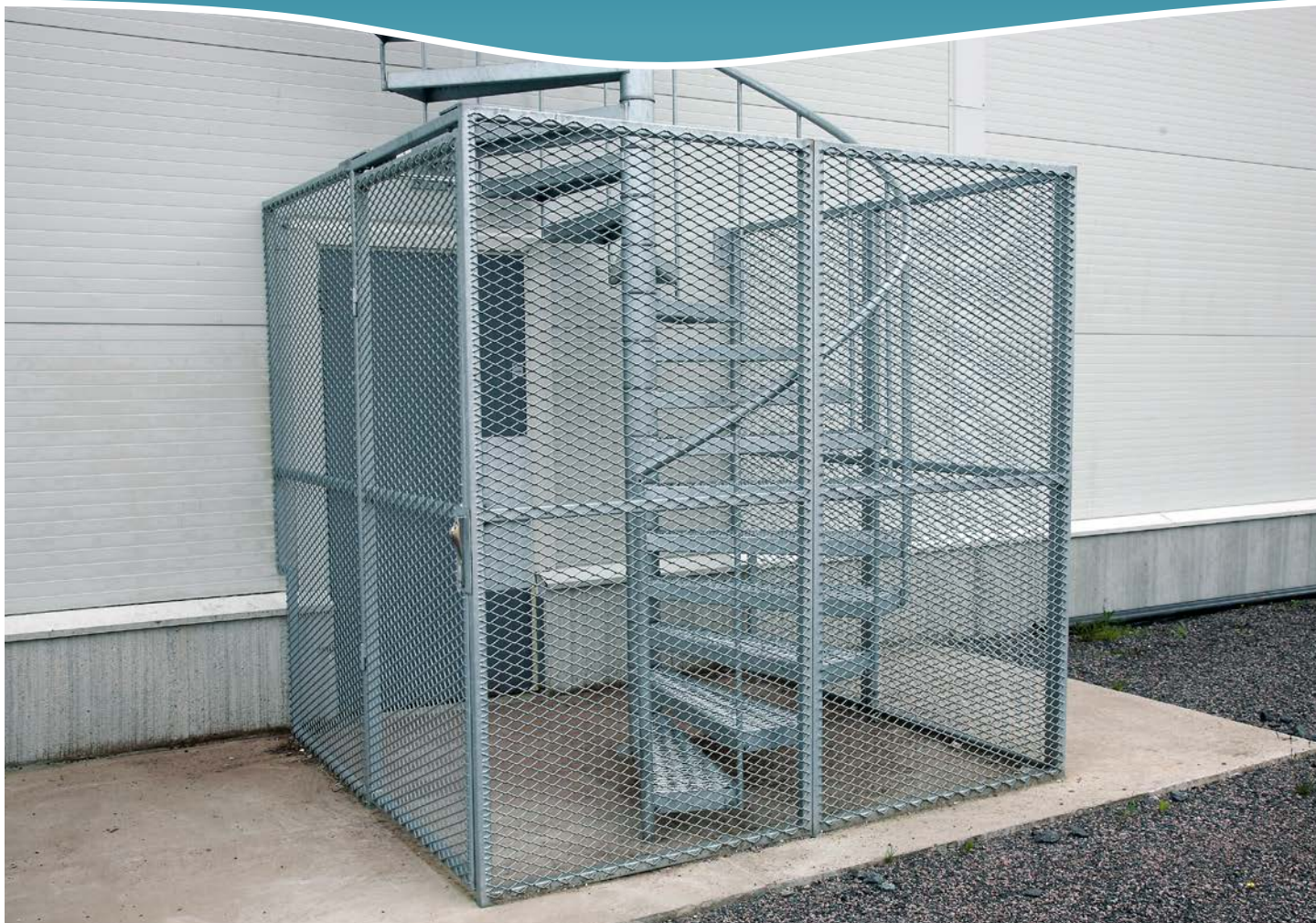
Spiraltrappa med skyddsbur av sträckmetall.
