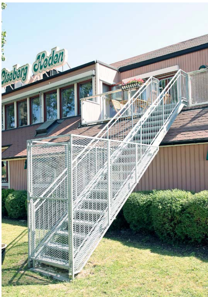
Rak trappa med skyddsbur av sträckmetall.
